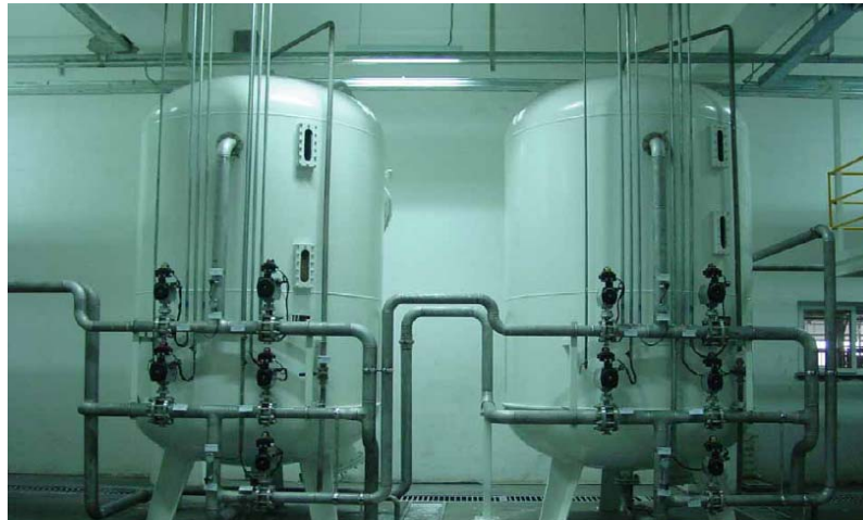
砂滤器和活性炭过滤器
