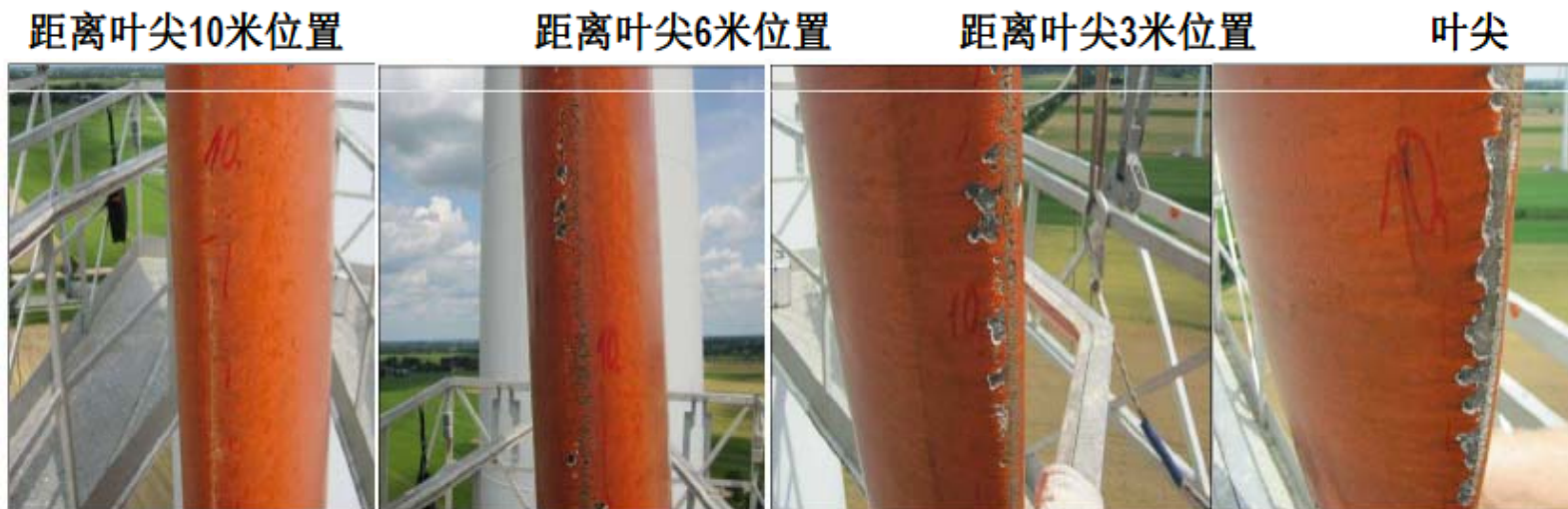
风电叶片前缘损伤照片
